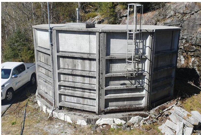
Figur 4-2. Bilete av høgdebassenget for Hyllestad vassverk.
