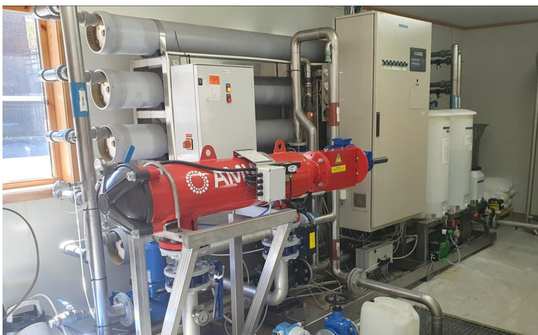
Figur 4-1. Bilete av Amiad forfilter (raud sylinder). Bakom forfilteret er det fem grå sylindrar som utgjer hovudlane av membranfiltreringen.
